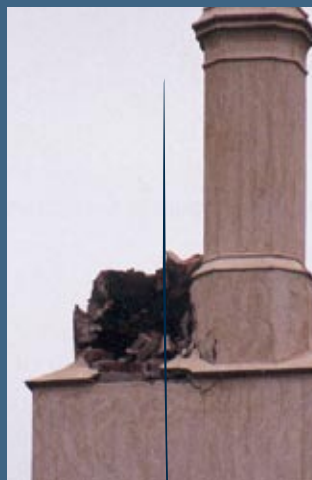
Daño producido por un rayo
